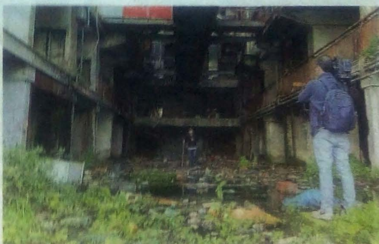
Torre Verde, fogna a cielo aperto Palude e rifiuti nella Vela, Sos al sindaco
